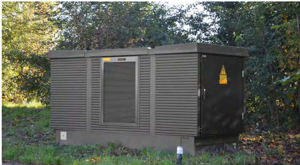
Afbeelding 20. Referentiebeeld transformator, Diabolo SHL bron: alfen.com
