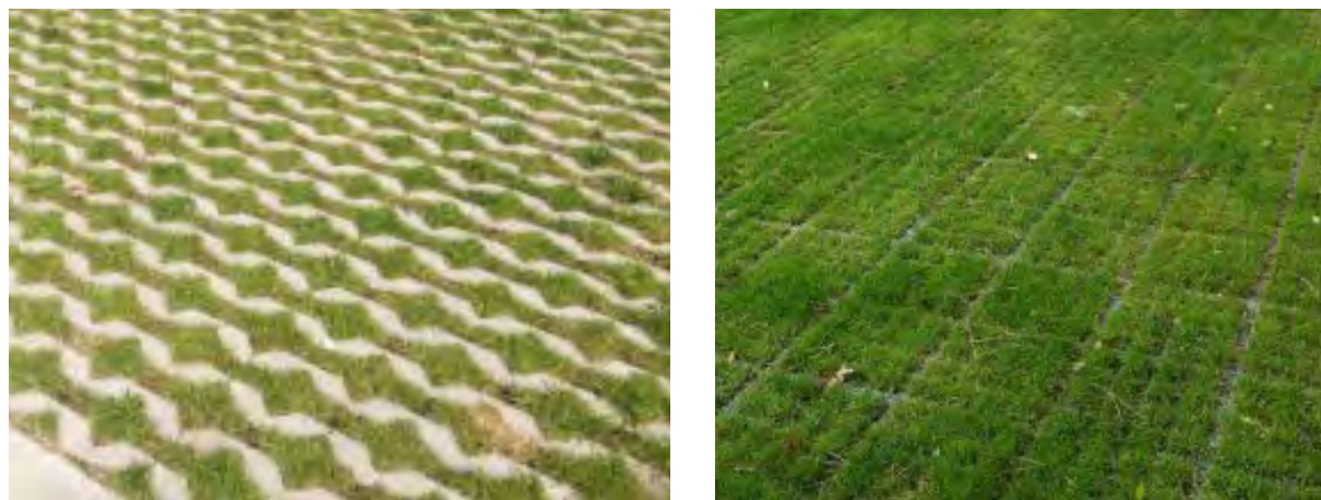
Afbeelding 20. Uitstraling grasbeton onderhoudspad van openbare weg naar klantstation en transformatoren.
